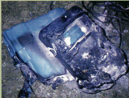
▲ 焼損したリチウムイオンバッテリー
